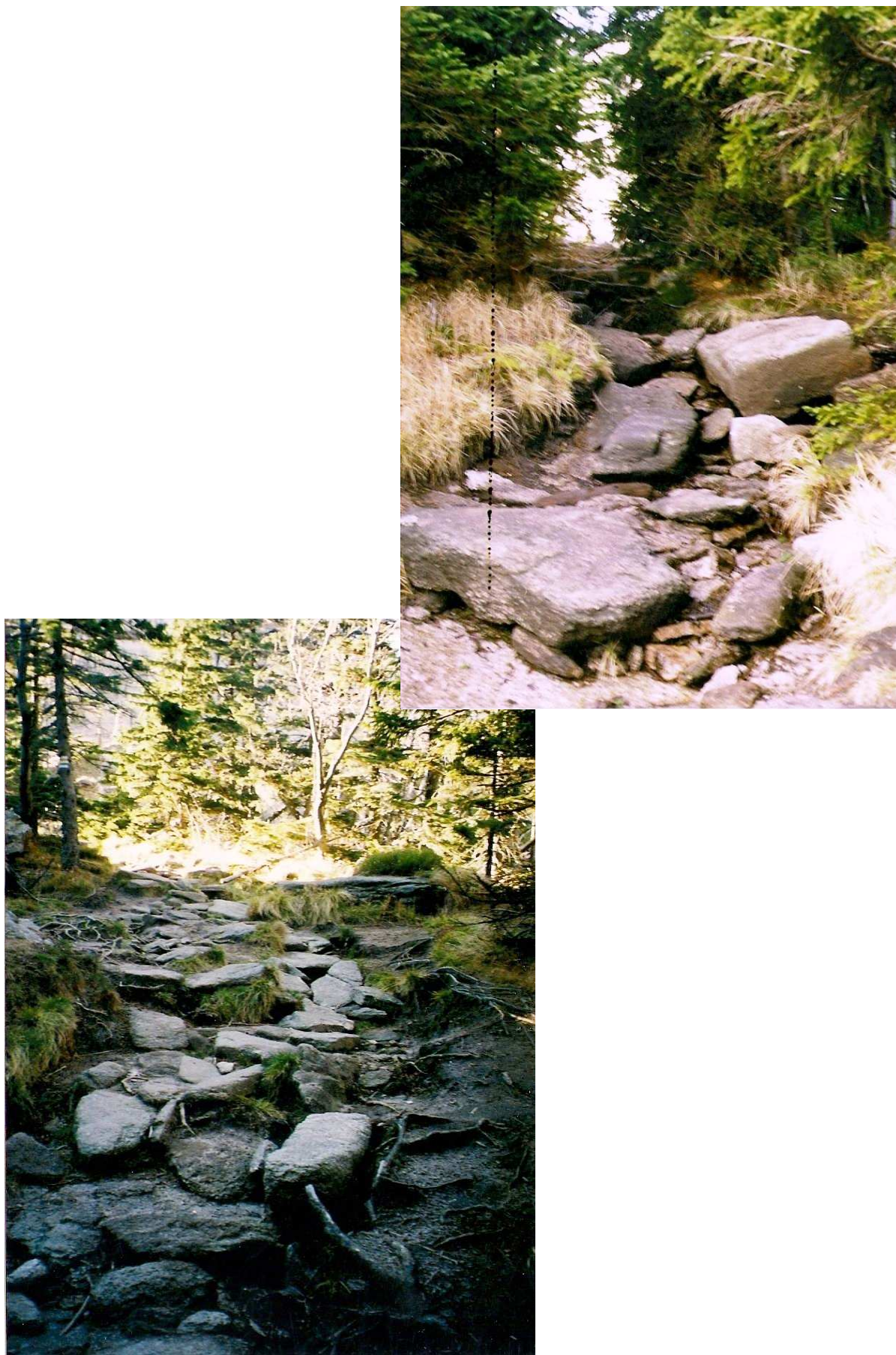
Fot. 5, 6, 7 i 8. Odcinek II - zniszczona brukowana nawierzchnia szlaku.
