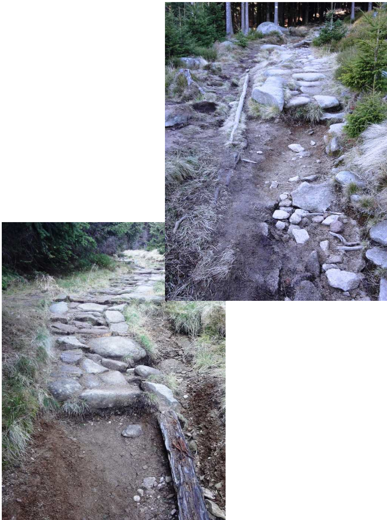
Fot. 1 i 2. Odcinek I – fragmenty brukowanej nawierzchni szlaku do naprawy
