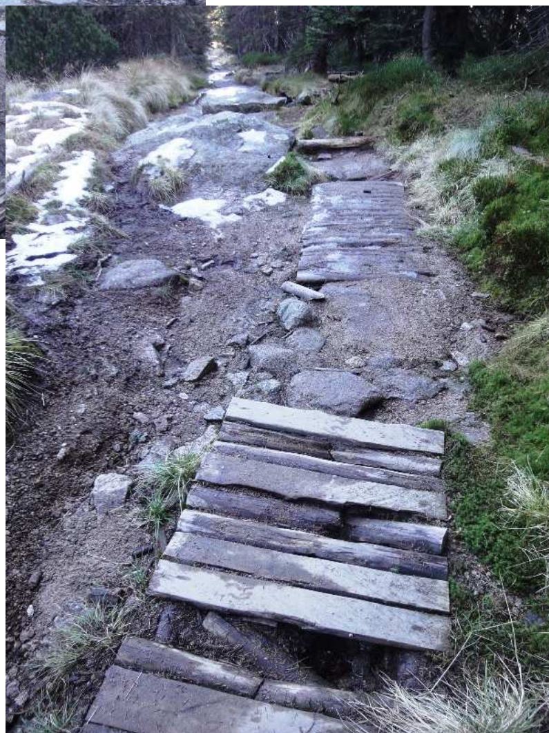
Fot. 9, 10, 11 i 12. Odcinek III. Zniszczone pomosty drewniane w okolicy Pielgrzymów.
