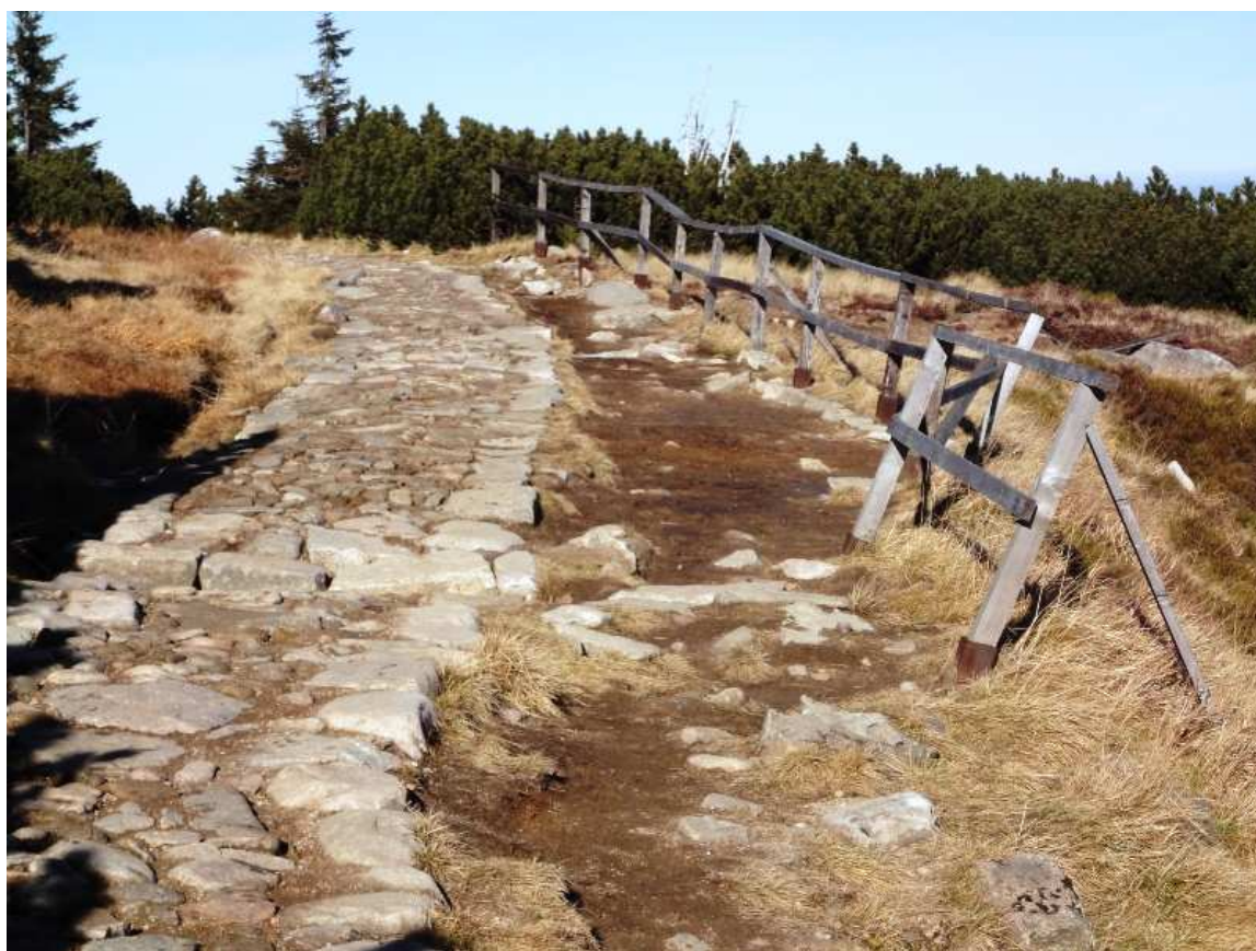
Fot. 3. Istniejące balustrady drewniane do wymiany.
