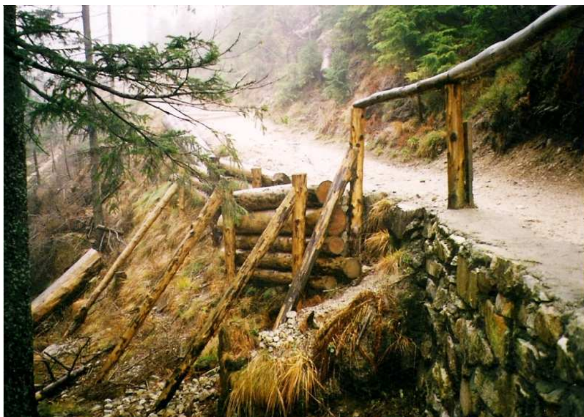
Fot. 7. Wzmocnienie osuwiska korony szlaku.
