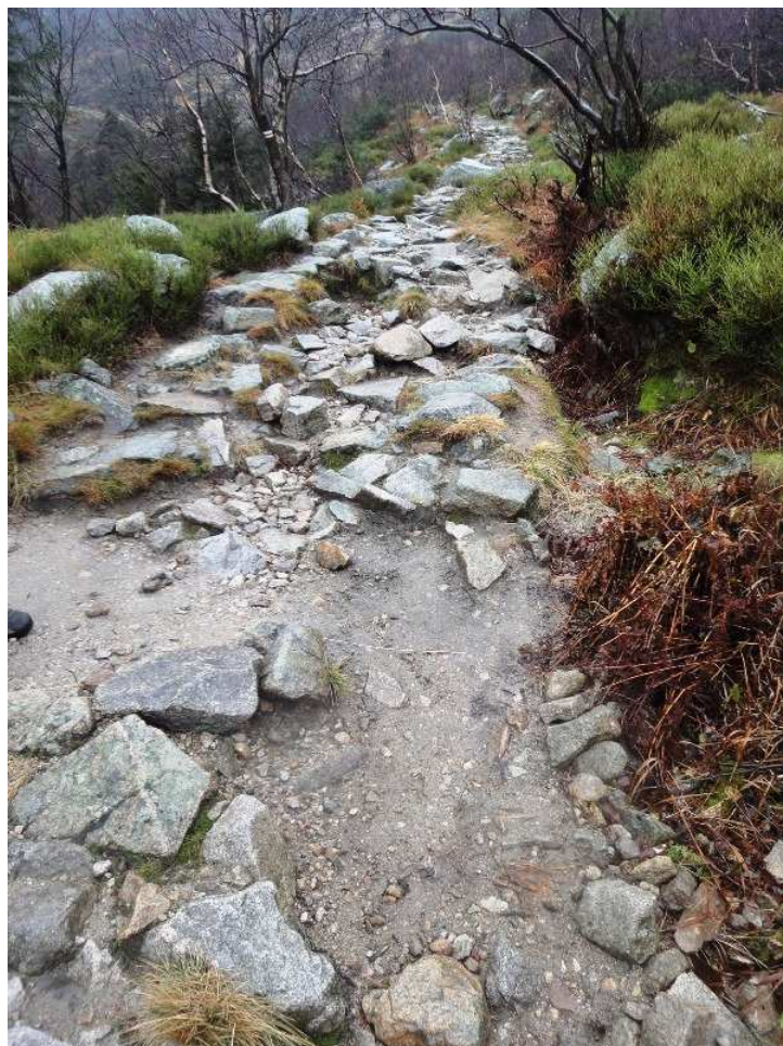
Fot. 8, 9 i 10. Zniszczona brukowana nawierzchnia szlaku
