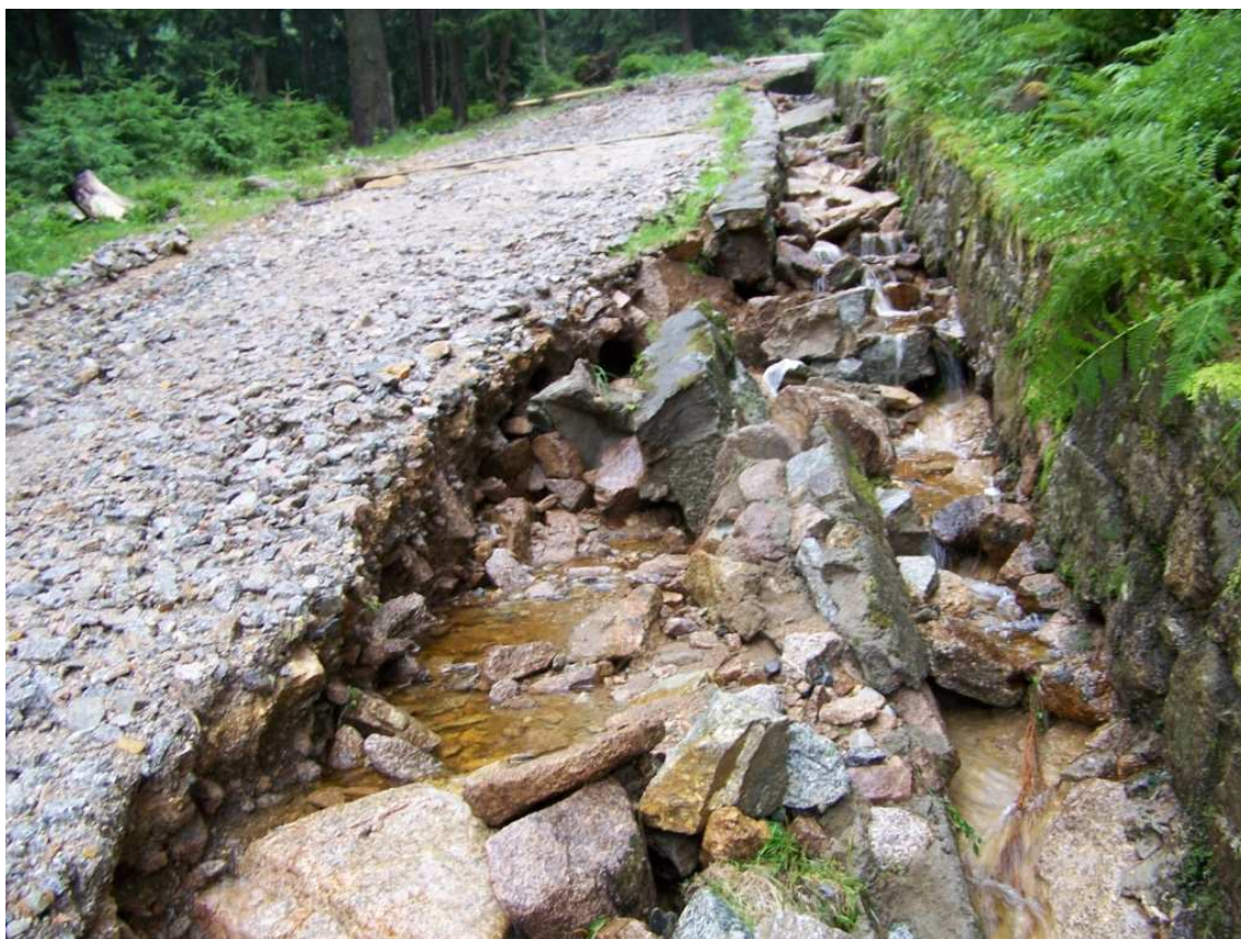
Fot.13. Na zdjęciach powyżej przedstawiono odcinki szlaku, gdzie jest całkowicie zniszczony mur oporowy od strony korony drogi.
