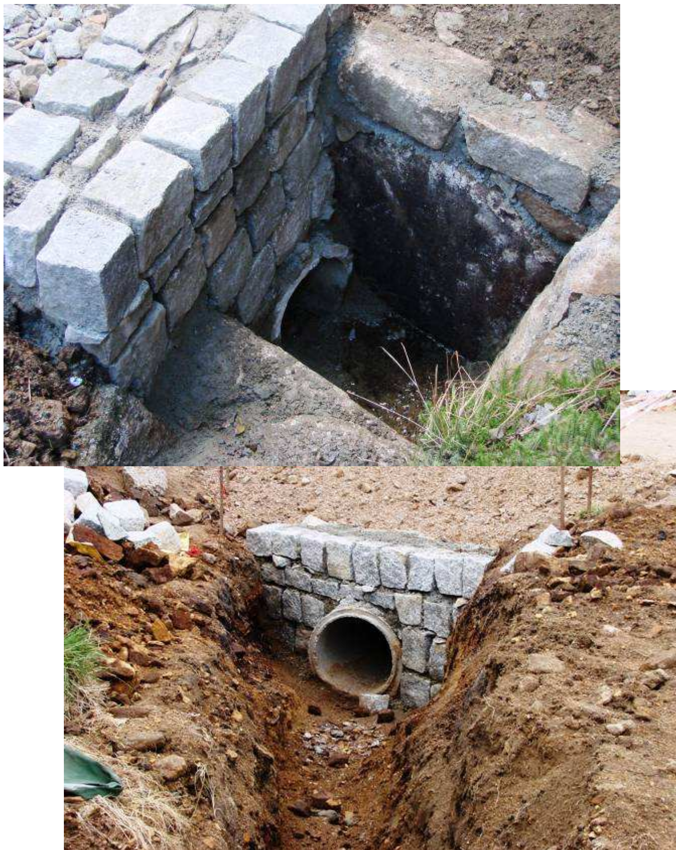
Fot. 17. Przepusty betonowe; prawidłowy wlot i wylot z rowem odprowadzającym wodę.
