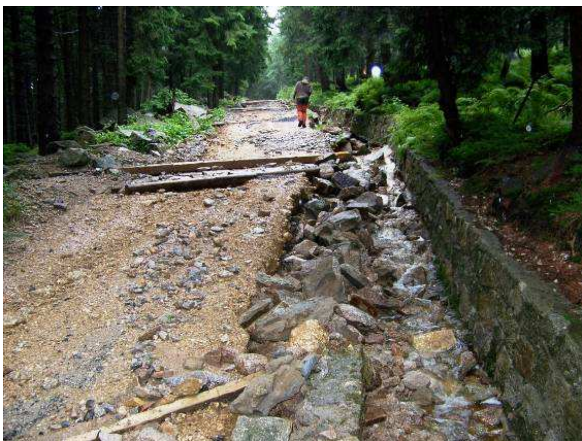
Fot.9. Podmyte i zniszczone progi drewniane.
