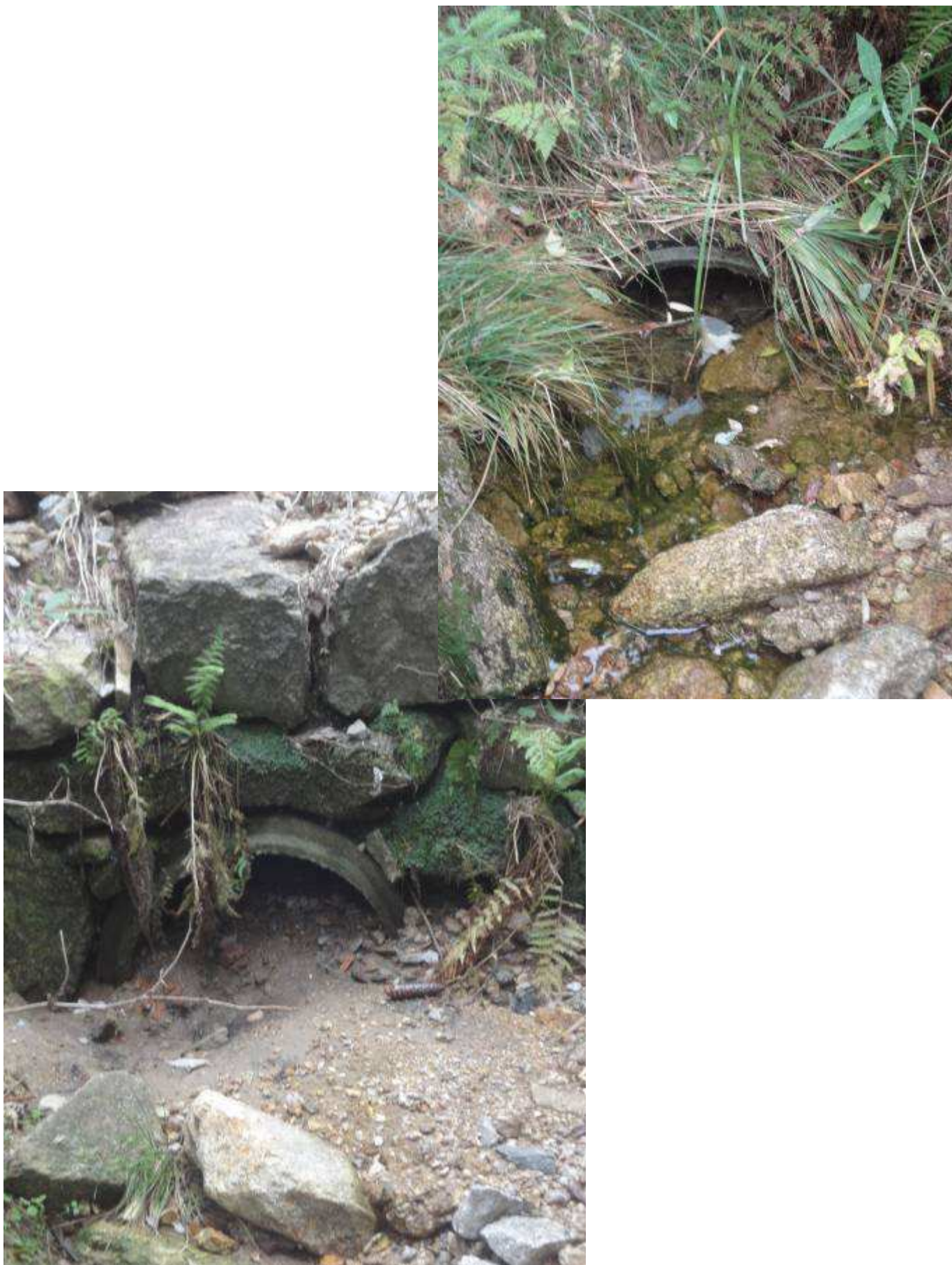
Fot. 10. Zamulone i zasypane wyloty z przepustów.
