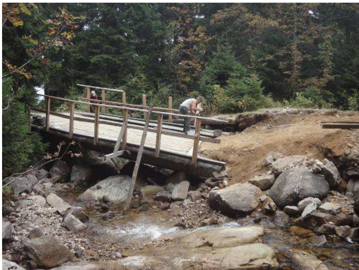
Fot.8. Zniszczona kładka nad potokiem łącznie z przyczółkami i skarpą od strony szlaku.
