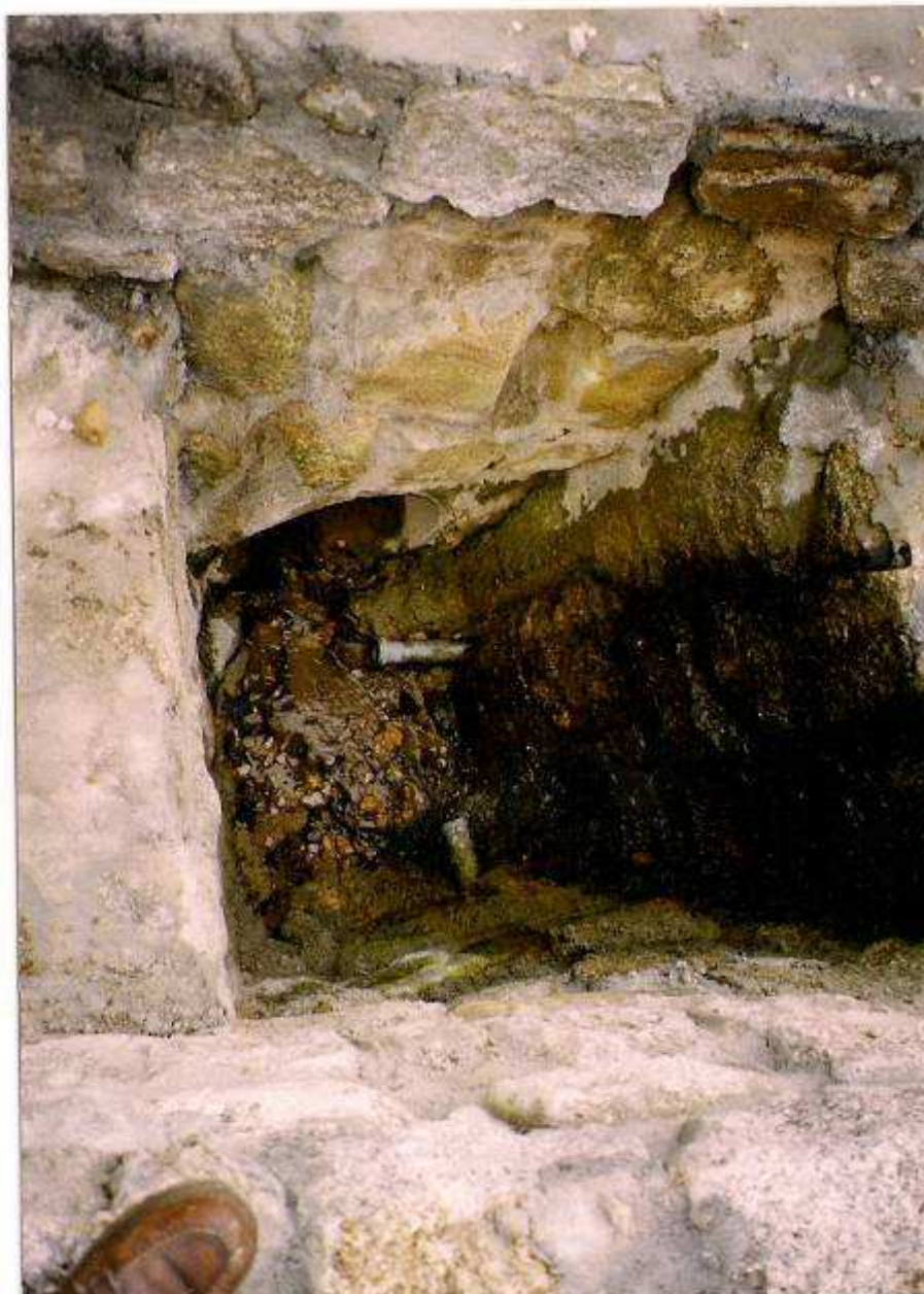
Fot.4. Wlot do przepustu, studzienka z odstojnikiem murowana z kamienia na zaprawie cementowej.
