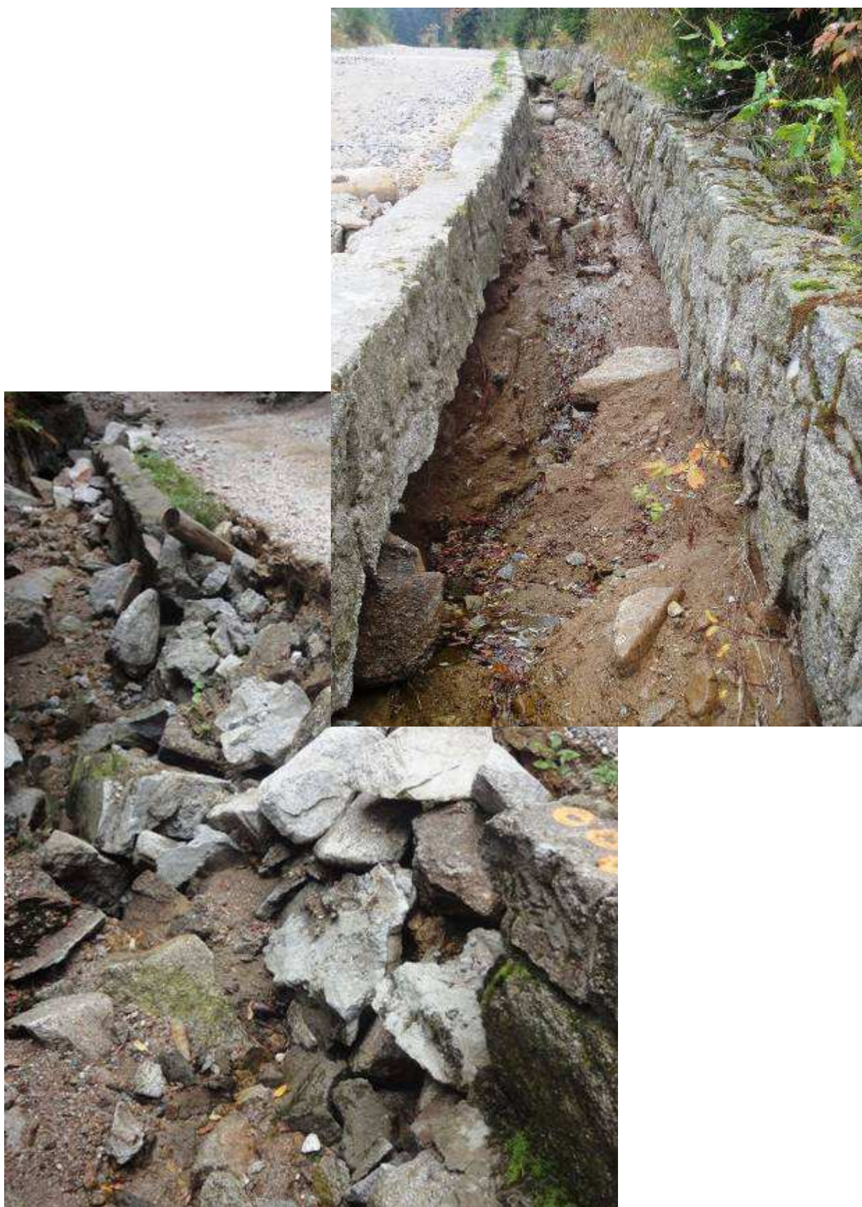
Fot.14. Na zdjęciach powyżej przedstawiono miejsca całkowitego zniszczenia dna rowu łącznie z wymyciem gruntu na gł. do 1.00m
