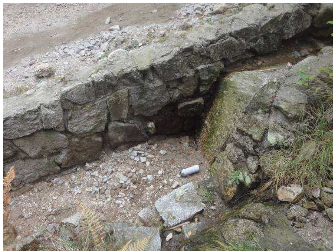
Fot.11. Wloty do przepustów całkowicie zasypane ogromną ilością materiału skalnego naniesionego przez wartki nurt płynącej wody.
