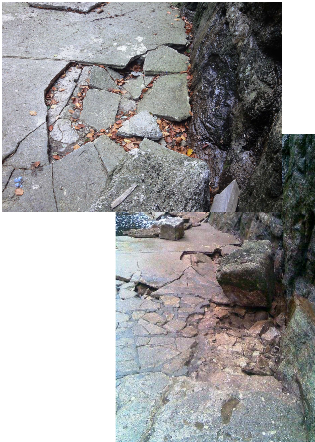
Fot.3 i 4. Zniszczona nawierzchnia pomostu widokowego (część I).
