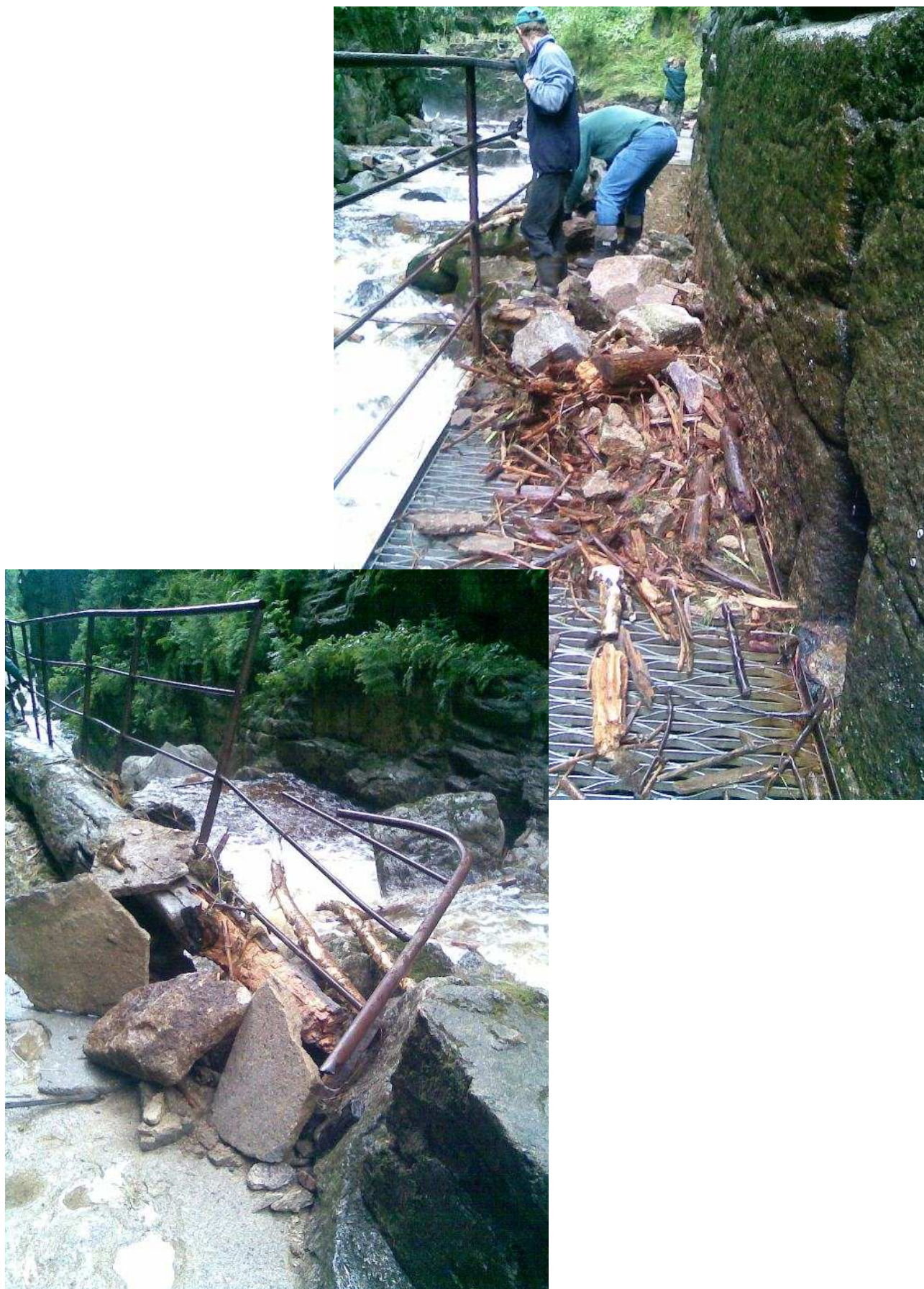
Fot.1 i 2. Zniszczenia na pomoście metalowym po przejściu wysokiej wody.
