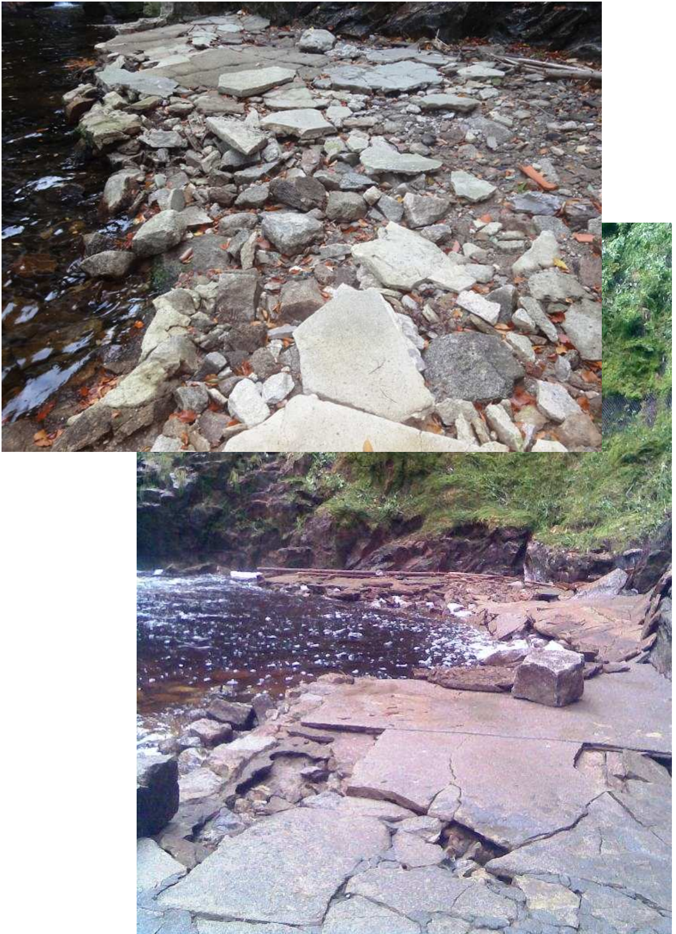
Fot.5 i 6. Całkowicie zniszczony pomost widokowy (część II).
