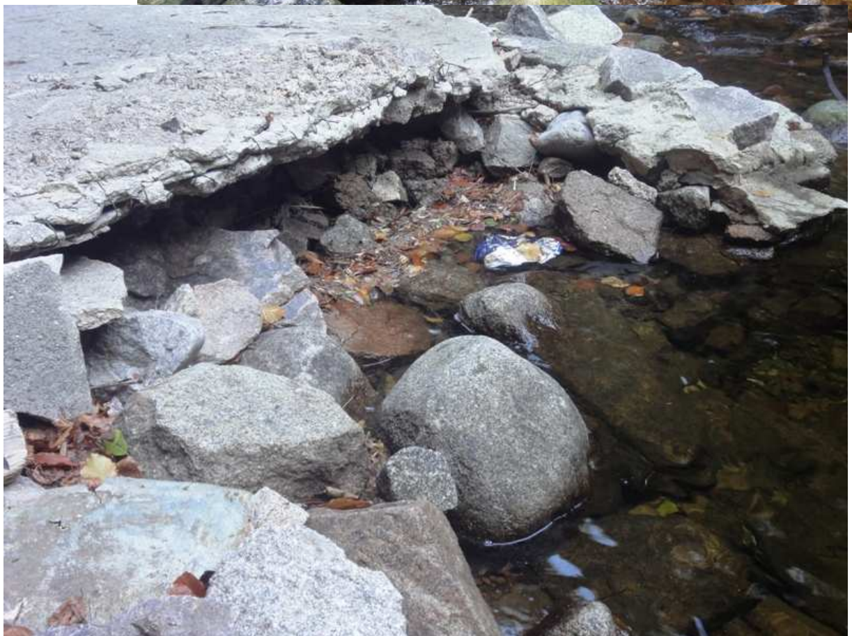
Fot.9 i 10. Zniszczone mury oporowe z kamienia.
