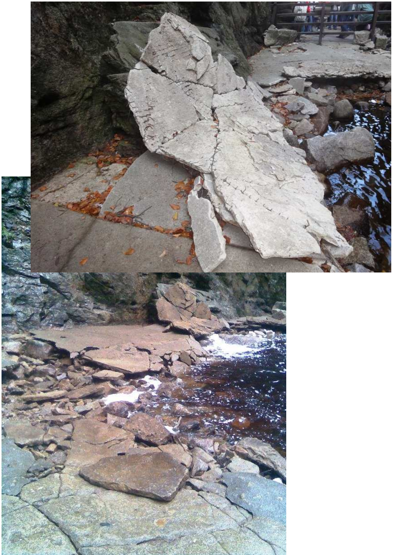
Fot.7 i 8. Zniszczony pomost widokowy (część II).
