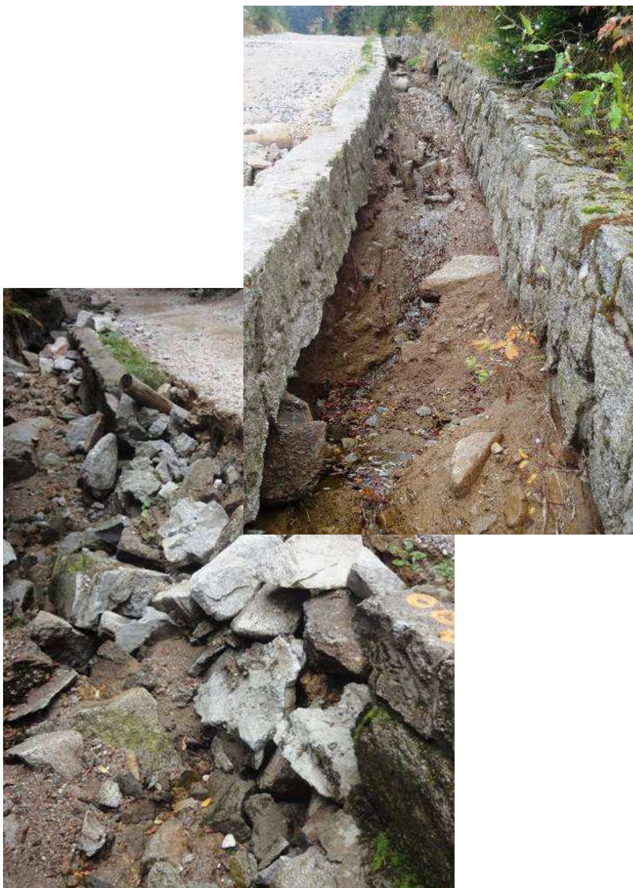
Fot.14. Na zdjęciach powyżej przedstawiono miejsca całkowitego zniszczenia dna rowu łącznie z wymyciem gruntu na gł. do 1.00m
