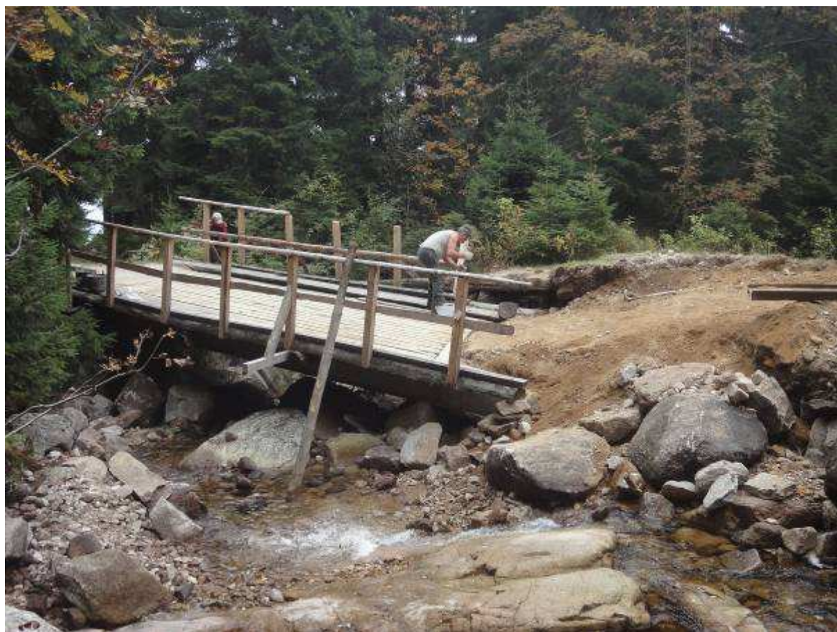
Fot.8. Zniszczona kładka nad potokiem łącznie z przyczółkami i skarpą od strony szlaku.
