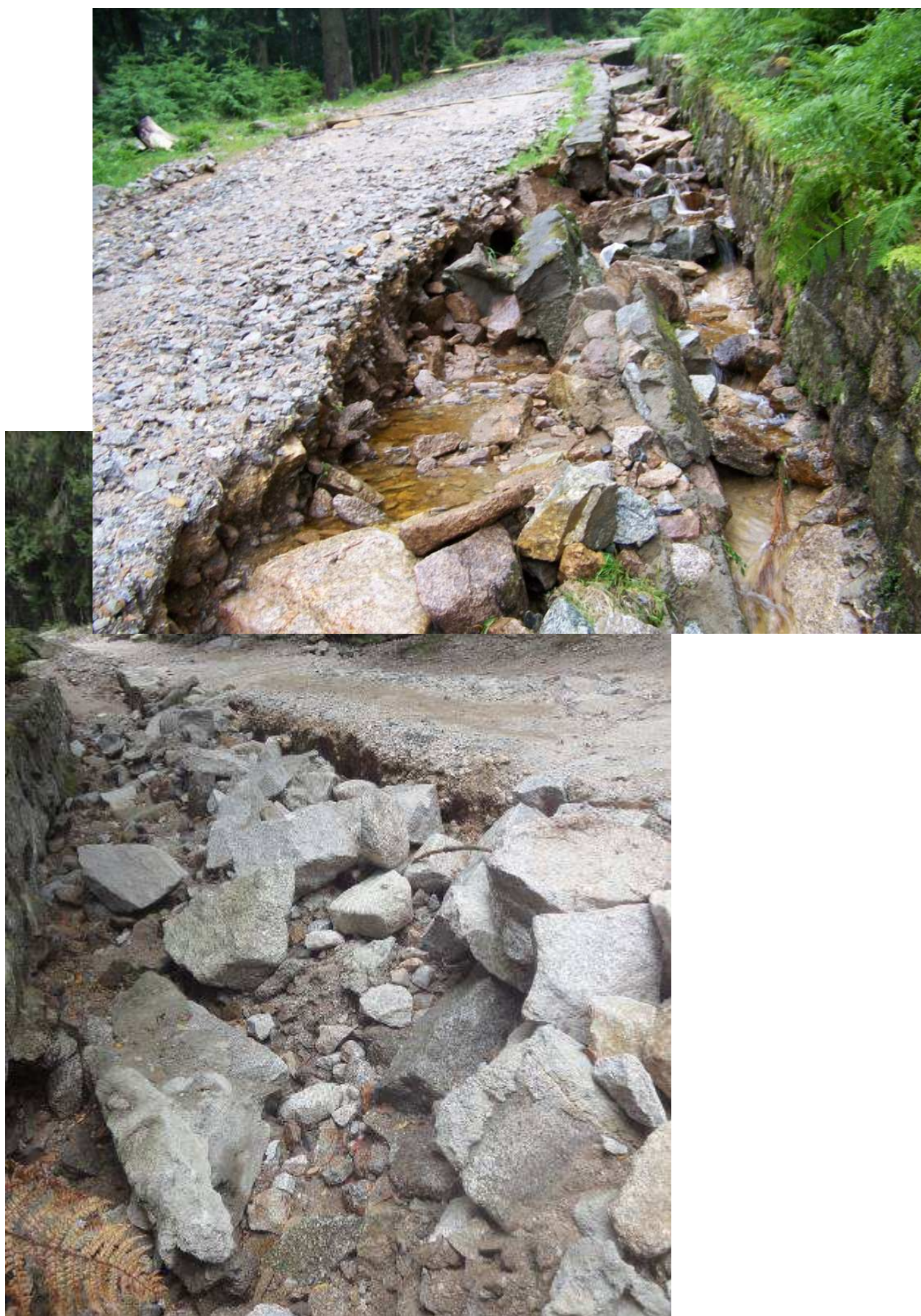
Fot.12. Zniszczone przyczółki przepustów z rur betonowych.
