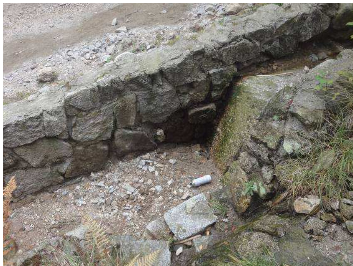
Fot.11. Wloty do przepustów całkowicie zasypane ogromną ilości materiału skalnego naniesionego przez wartki nurt płynącej wody.
