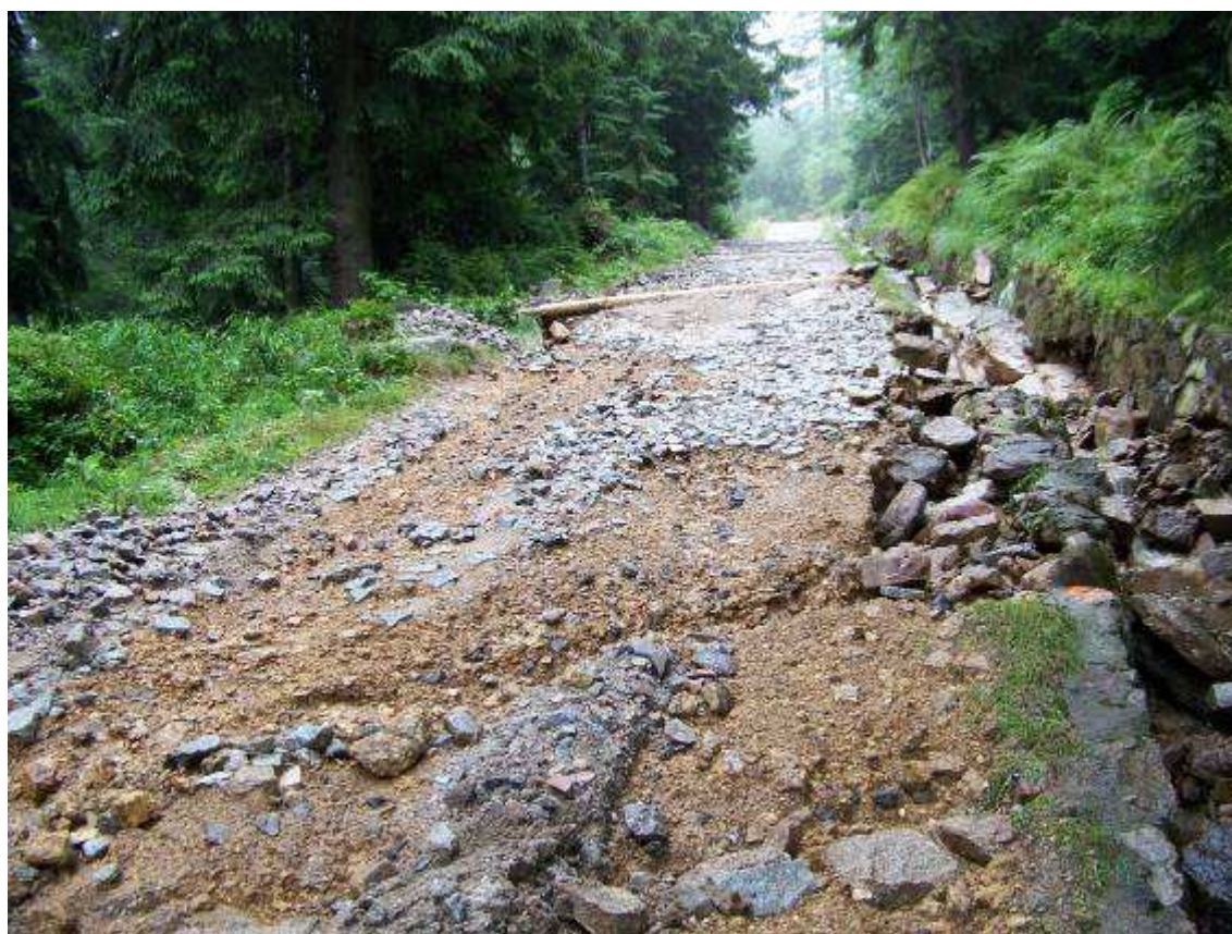
Fot.6. Zniszczona nawierzchnia tłuczniowa szlaku.
