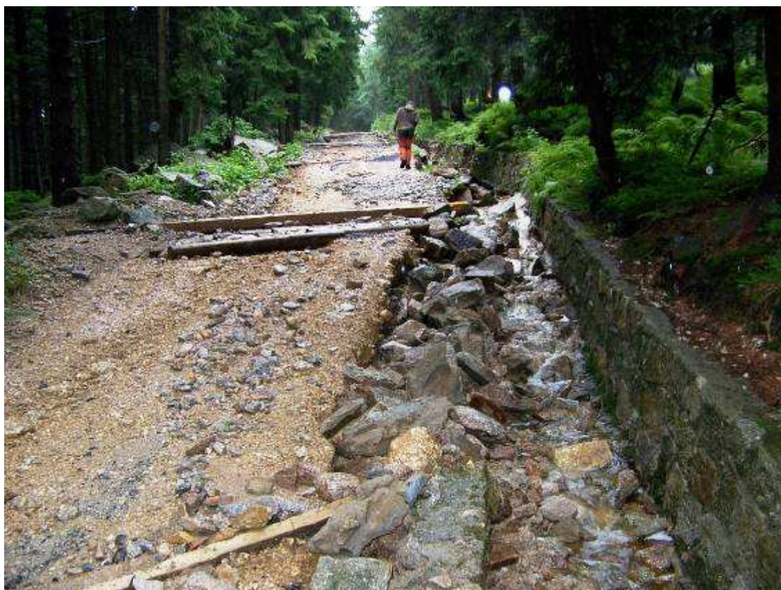
Fot.9. Podmyte i zniszczone progi drewniane.
