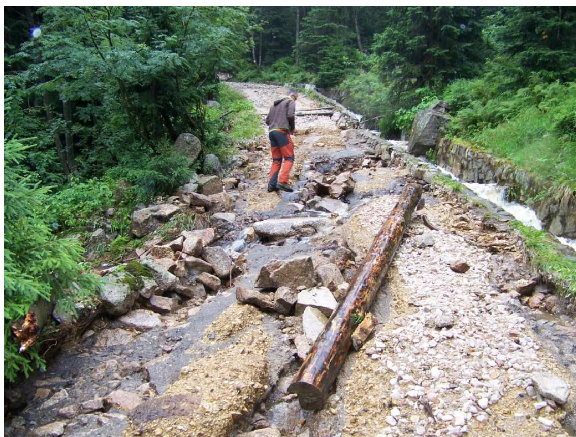
Fot.7. Zniszczona nawierzchnia łącznie z podbudową.
