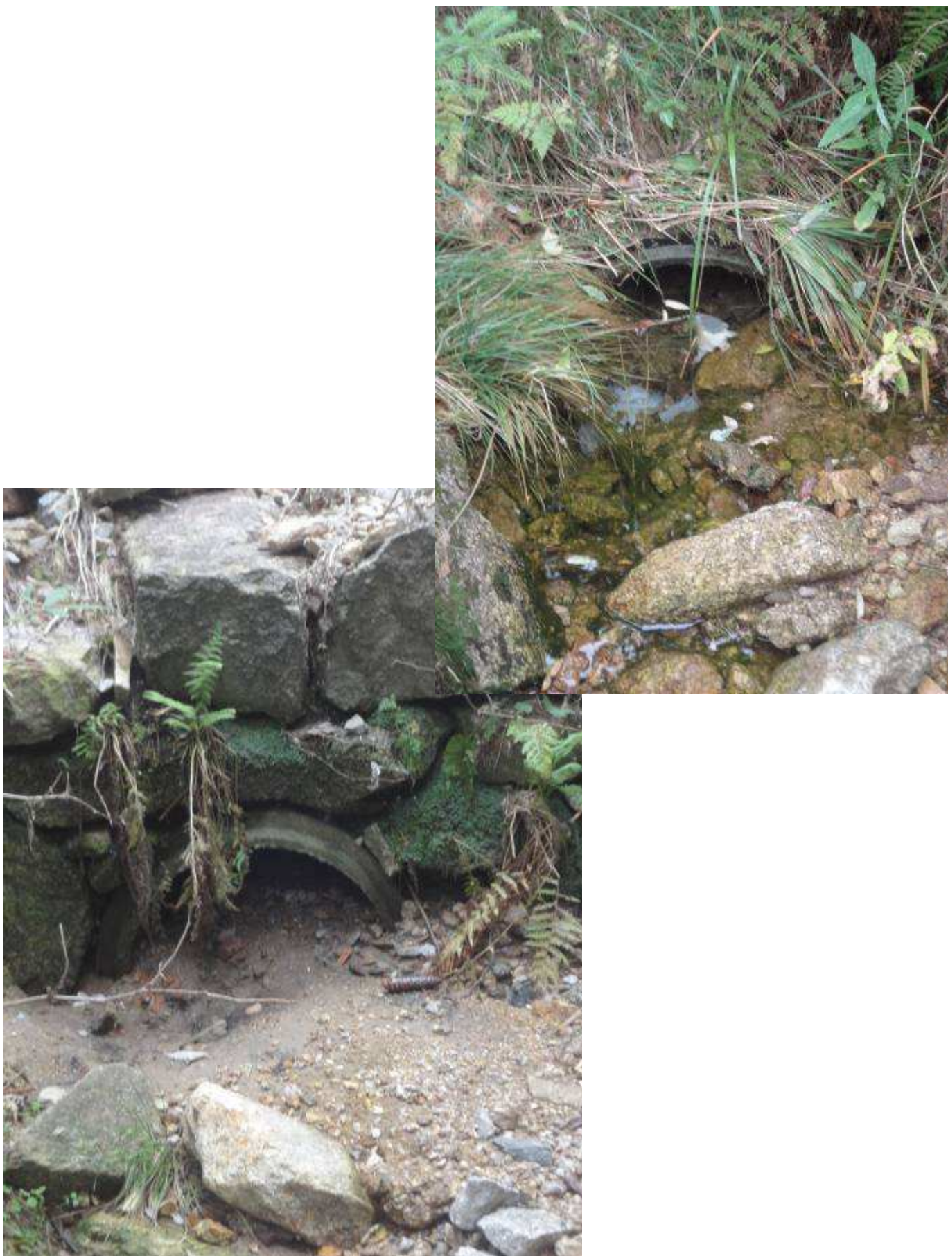
Fot. 10. Zamulone i zasypane wyloty z przepustów.
