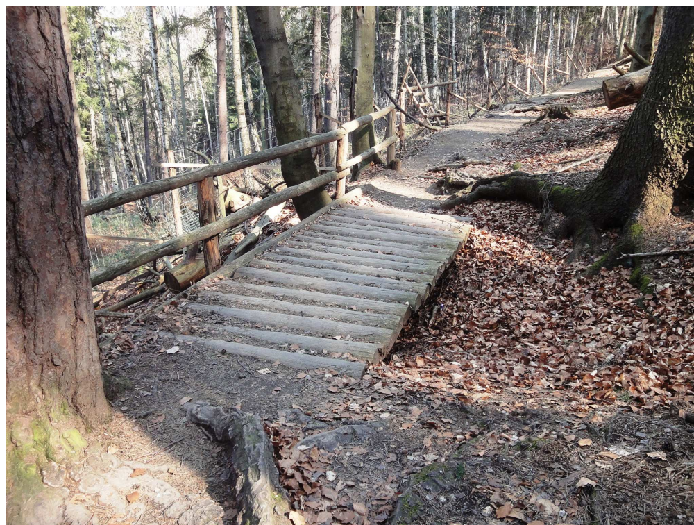
Fot. 6. Podest nad przepustem do wymiany.
