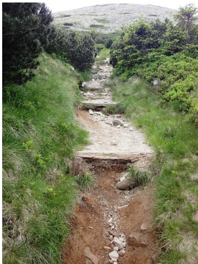
Fot. 20, 21 i 22. Zniszczone przepusty kamienne, zarośnięte rowy i zniszczone progi.
