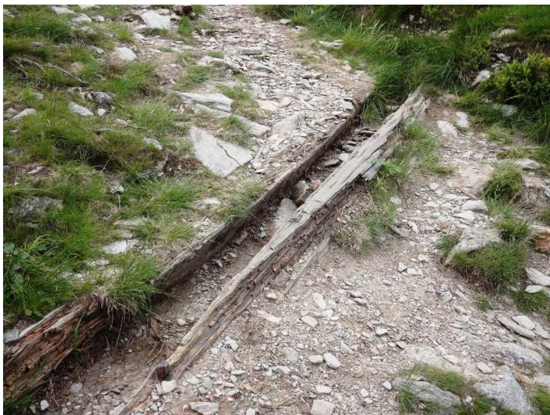
Fot. 16 i 17. Zniszczone progi drewniane.
