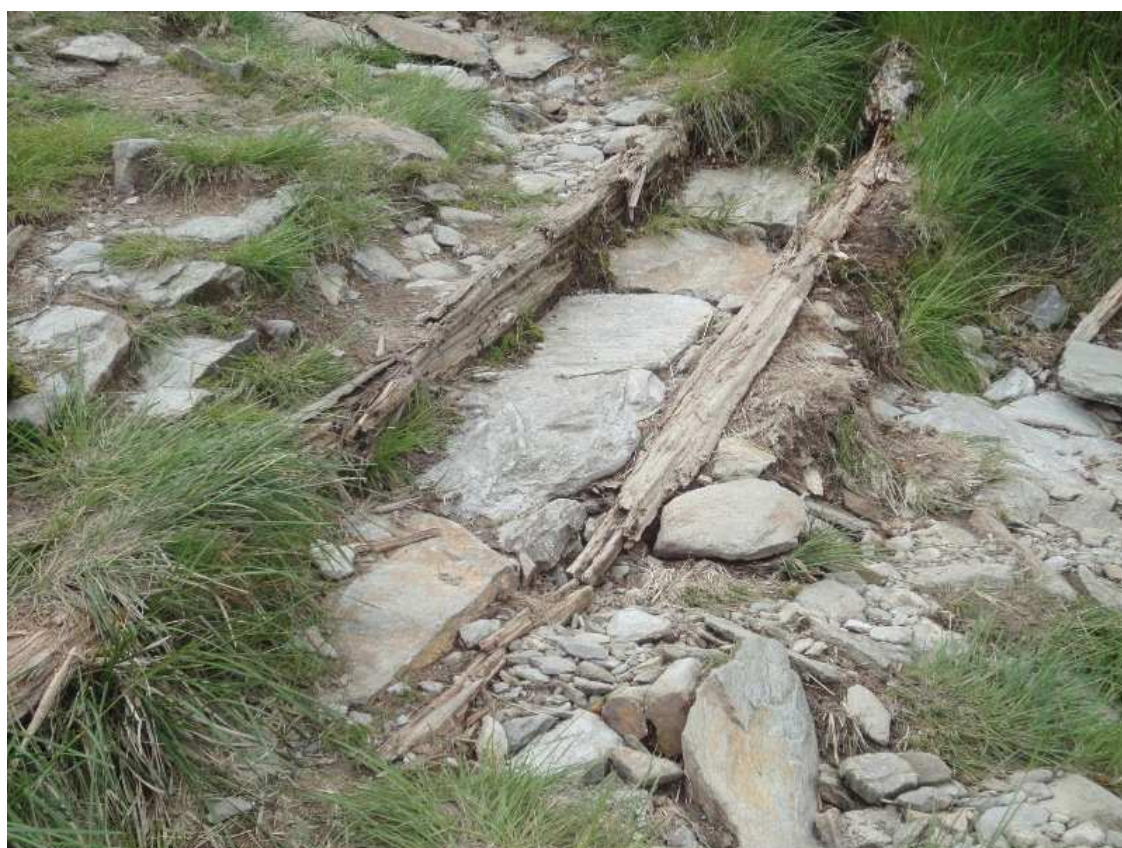
Fot. 18 i 19. Zniszczone odkryte przepusty drewniane.
