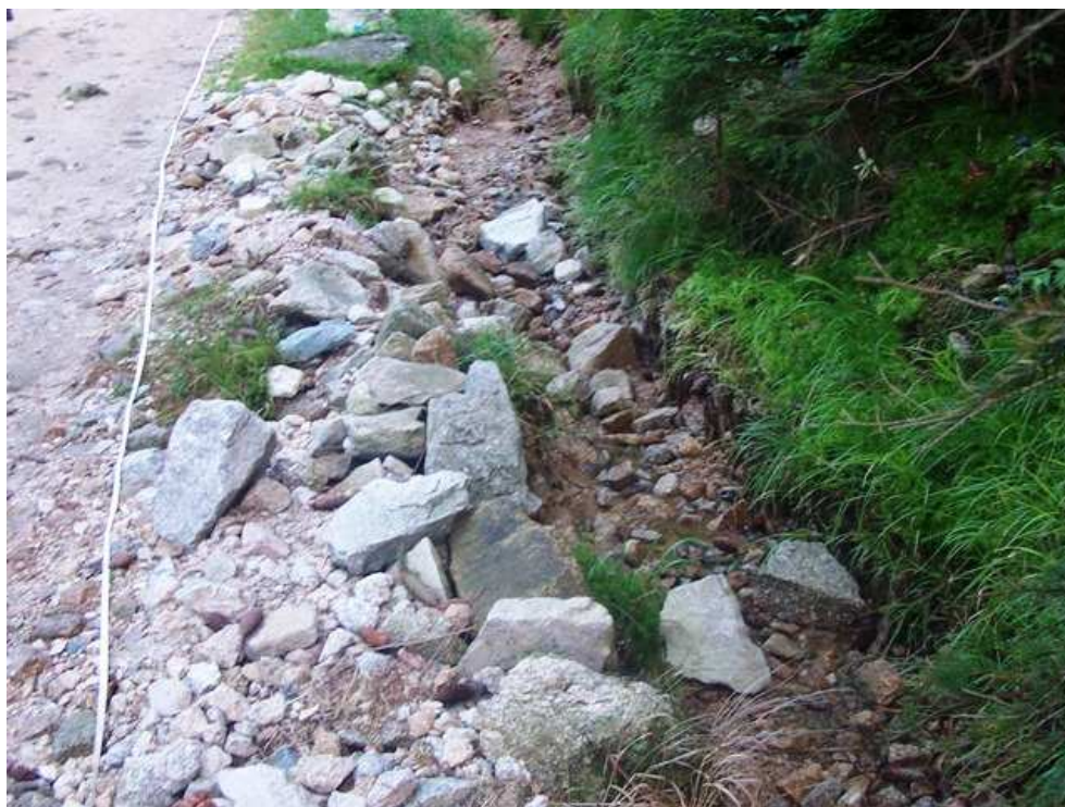
Fot. 3 i 4. Zasypane i zamulone rowy.
