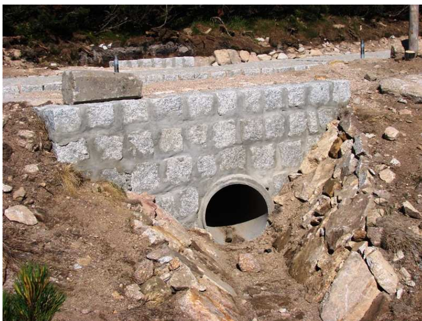
Fot. 8. Przepusty rurowe; wylot z przepustu wraz z umocnieniem rowu odprowadzającego wodę kamieniem miejscowym.
