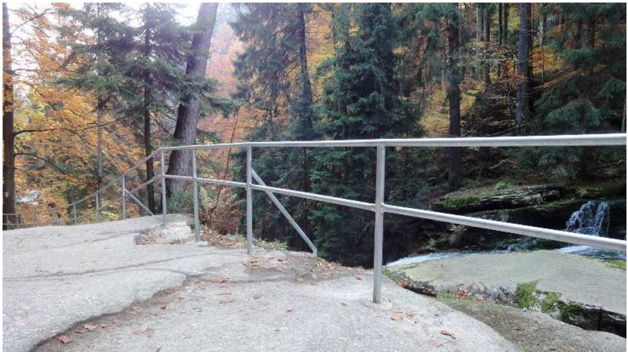
Fot.1 i 2. Balustrady istniejące powyżej schroniska.
