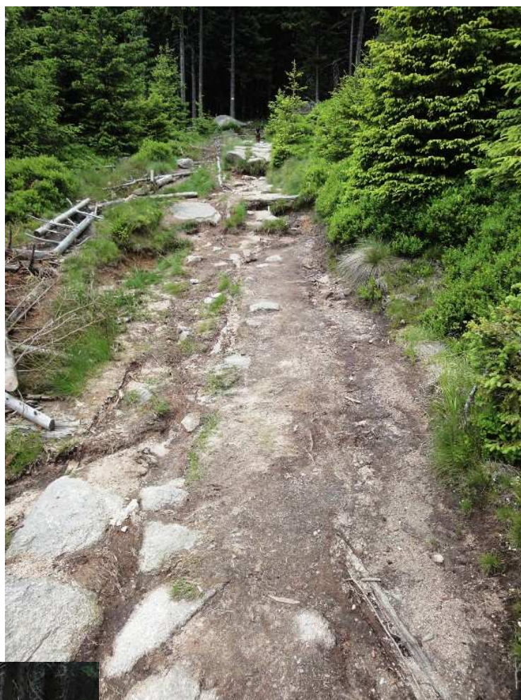
Fot. 8 i 9. Zniszczona nawierzchnia kamienista, zarośnięty przepust.
