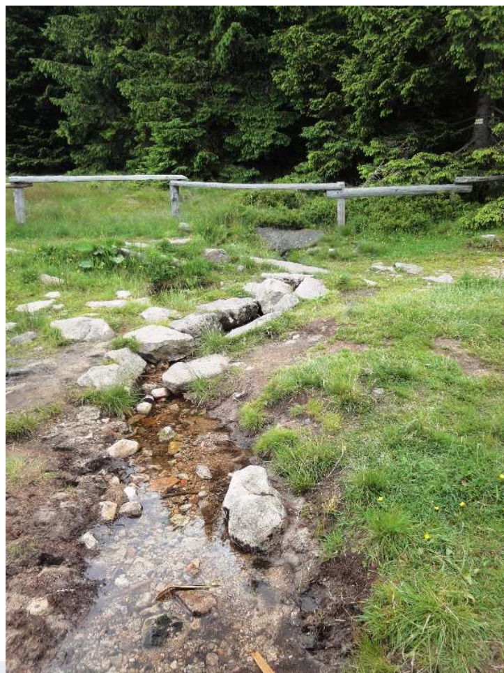
Fot. 2 i 3. Fragmenty brukowanej nawierzchni szlaku do remontu.
