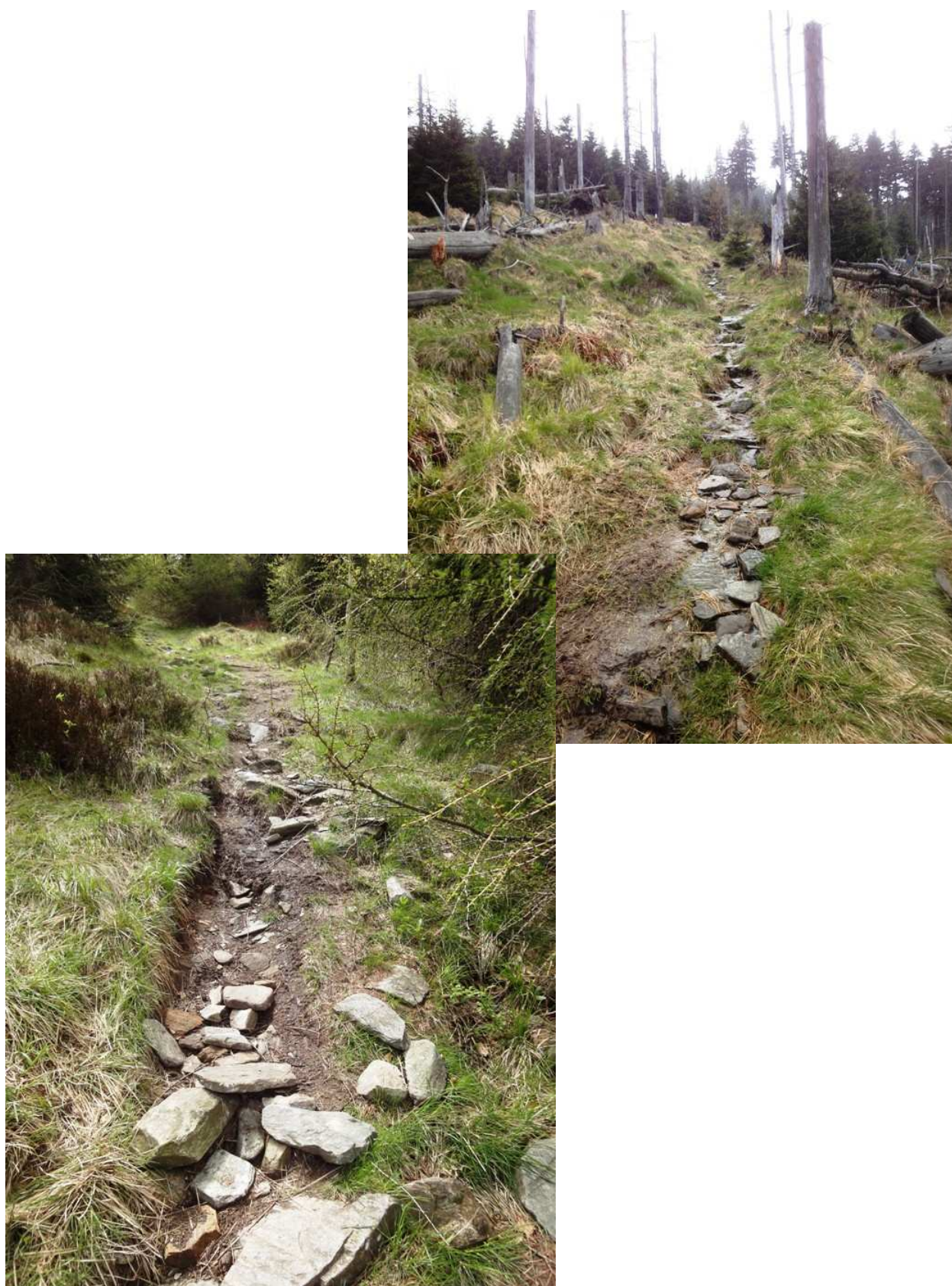
Fot. 4 i 5. Zniszczona nawierzchnia brukowana – w czasie opadów zamienia się w strumień.
