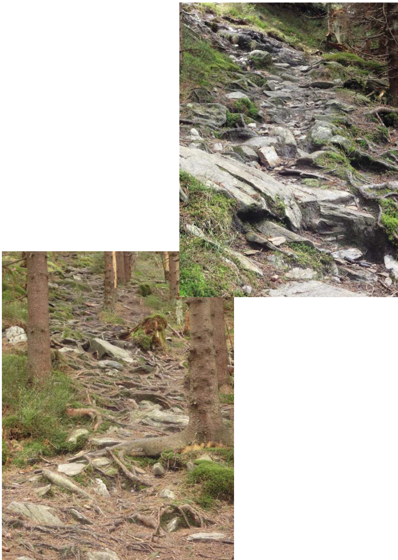
Fot. 10, 11, 12 i 13. Zniszczona nawierzchnia szlaku na II odcinku szlaku żółtego.
