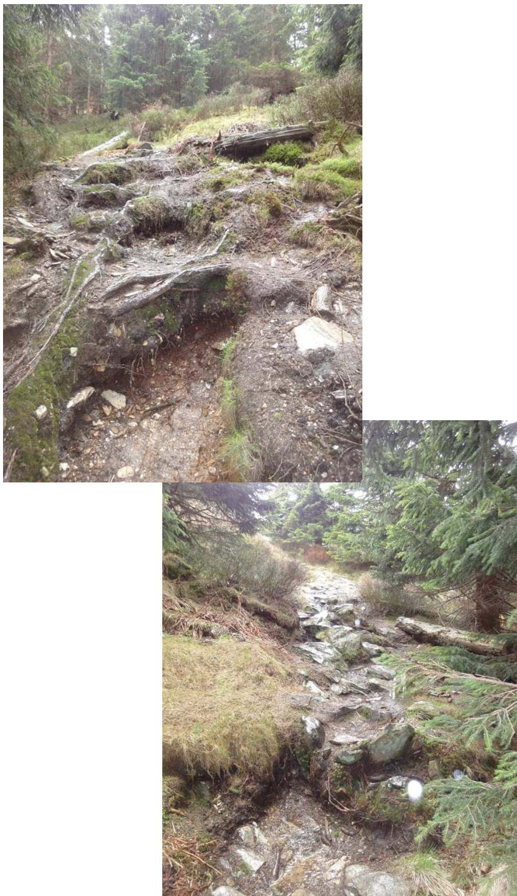
Fot.14 i 15. Nawierzchnia szlaku bardzo zniszczona – brak bezpiecznego przejścia szlakiem.
