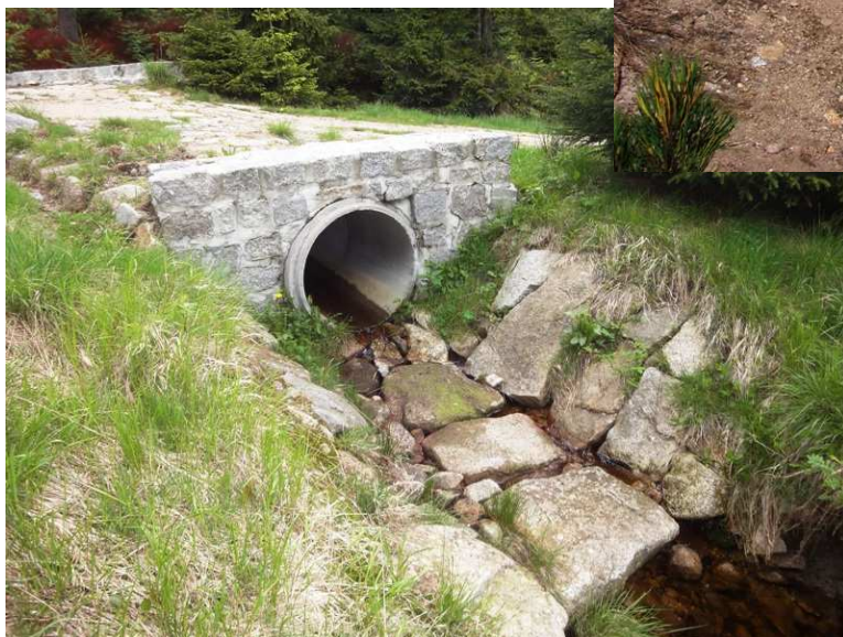
Fot. 3, 4 i 5. Przepusty rurowe; wloty ze studzienką odstojsnikową, wyloty ze wzmocnionym dnem rowu odprowadzającym wodę.
