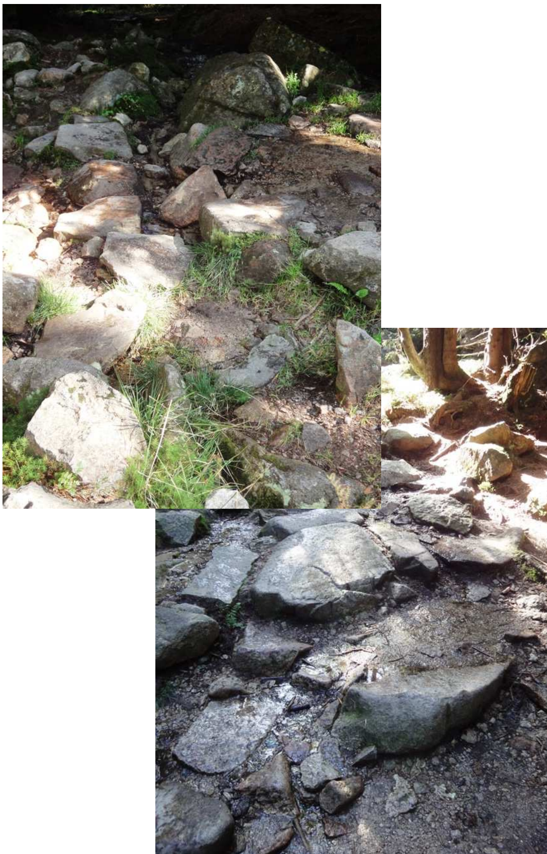
Fot. 11 i 12. Zniszczone przepusty kamienne – odkryte i płynąca szlakiem woda.
