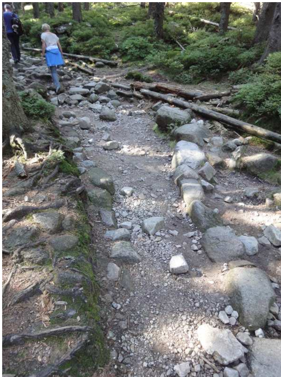
Fot. 6, 7, 8, 9 i 10. Zniszczona brukowana nawierzchnia szlaku
