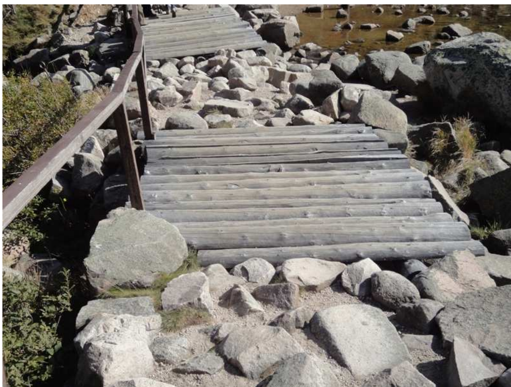
Fot.19. Zniszczone pomosty drewniane.
