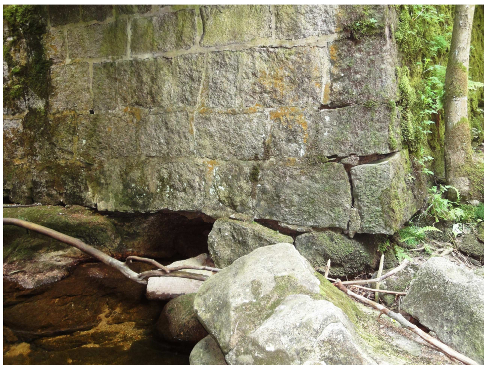
Fot.3. Przyczółek kładki II wymagający natychmiastowego podbicia.
