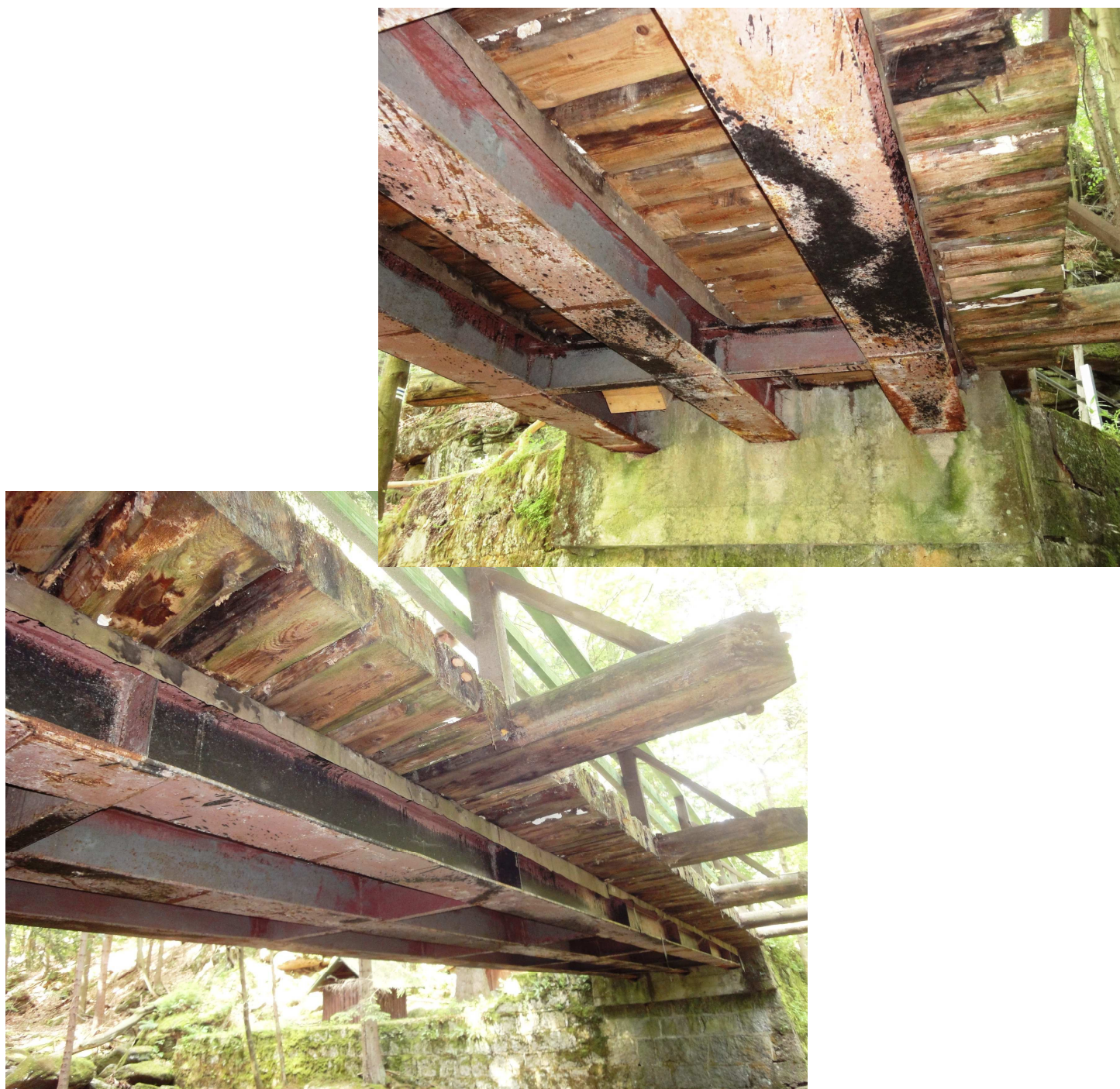
Fot. 4 i 5. Stan istniejący – kładka nr II.
