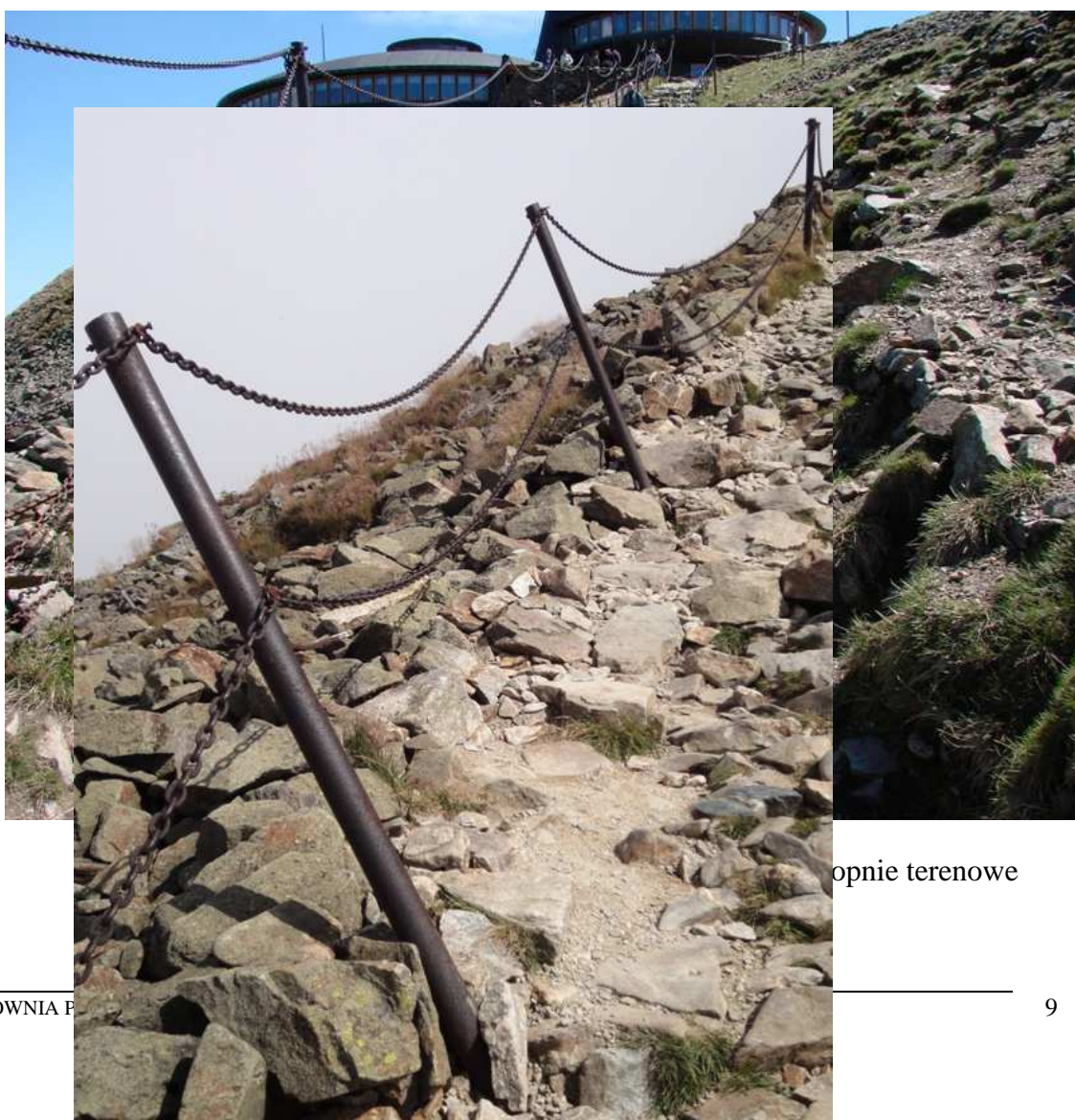
Fot.5, 6 i 7. Zniszczona nawierzchnia brukowana kamieniem miejscowym.
