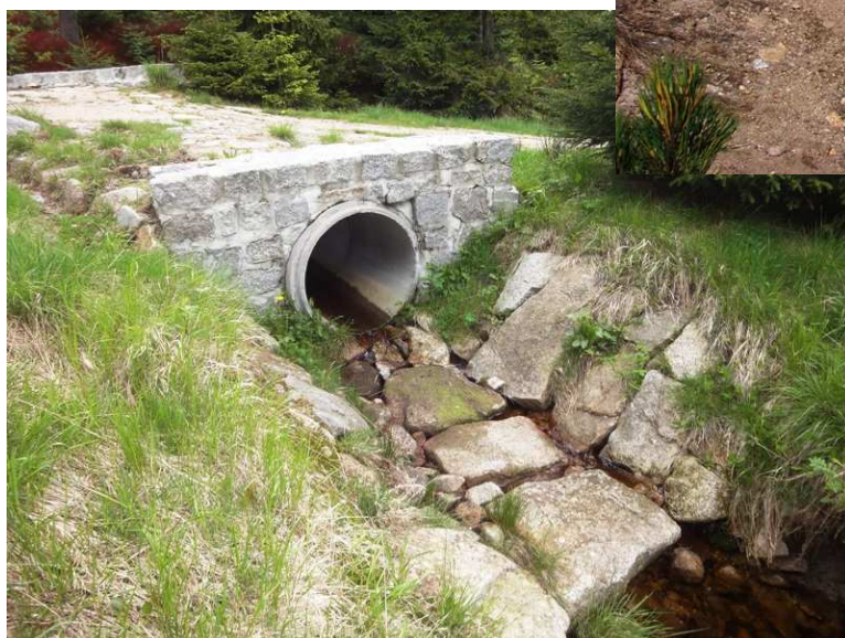
Fot. 3, 4 i 5. Przepusty rurowe; wloty ze studzienką odstojnikową, wyloty ze wzmocnionym dnem rowu odprowadzającym wodę.
